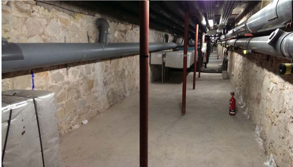
Fotografia de la Galeria d'instal·lacions amb la zona on posar els dipòsits de reg.
